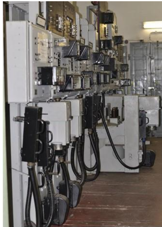
Ausgrid movable heritage switchgear
